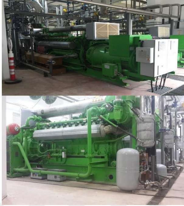
Şekil 3.2. Kojenerasyon sistemine ait görünüm [19].
