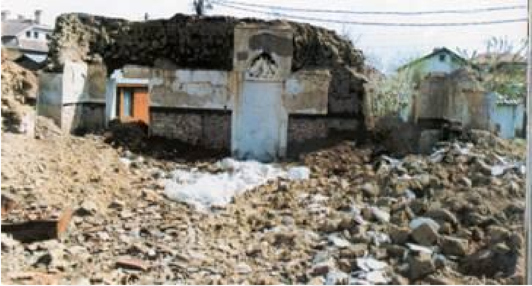
Resim 3.1: Sırp Tarafından Zarar Gören Büyük Medrese Binası
