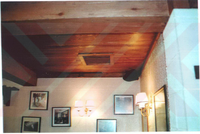
Resim 8.10: Tavandaki havalandırma menfezleri
