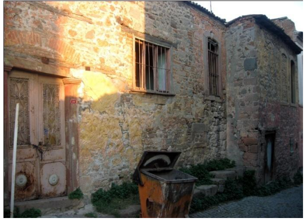
Resim 98: Talatpaşa Mah. Dede Sok. No. 20- Güneybatı cephe
