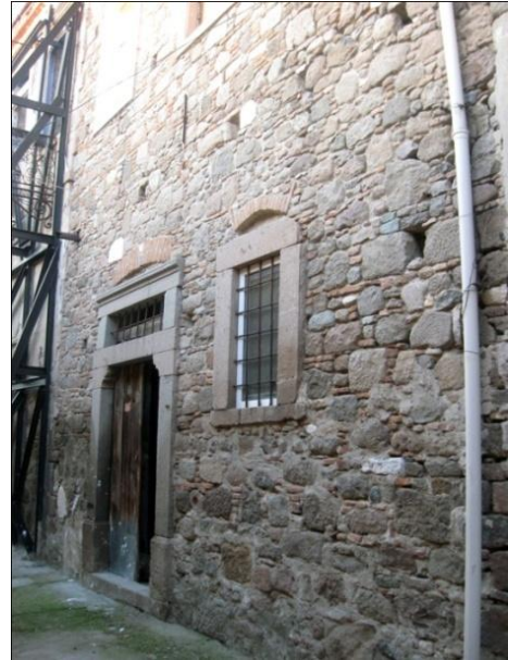
Resim 106: Talatpaşa Mah. Dünder Sok. No. 4- Güneybatı cephe
