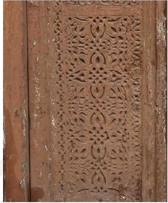
Fot.22- Sol kapı kanadı, üçüncü pano.
