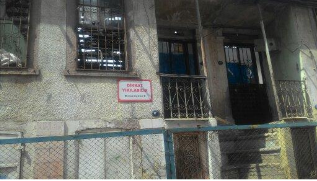
Fotoğraf 4: Yıkılmak Üzere Olan Bir Yapı
