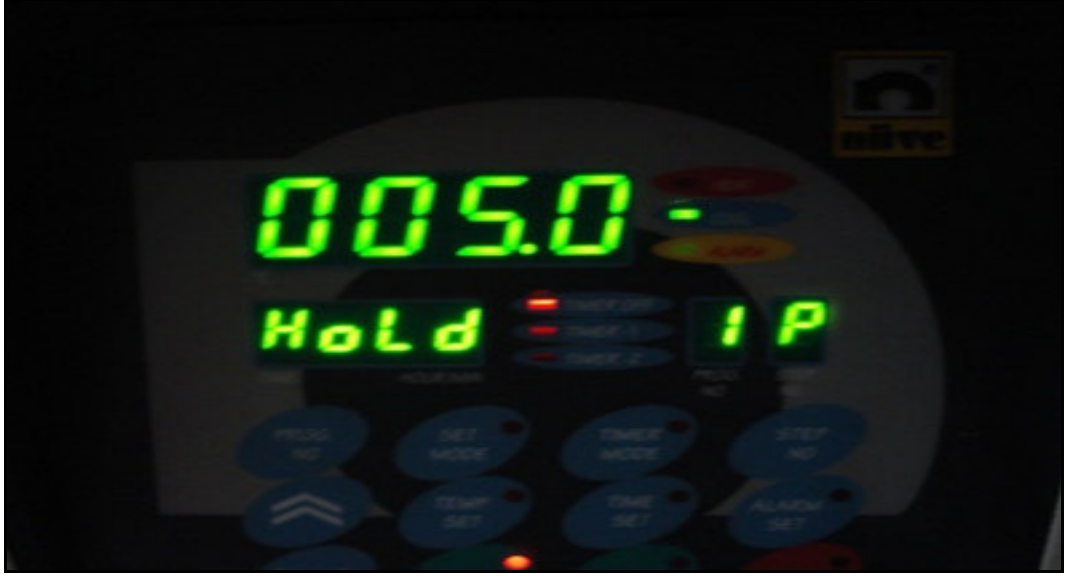
Şekil 3.12. Soğuk su banyosunun sıcaklığının programlandığı ve sıcaklığın izlendiği pano
