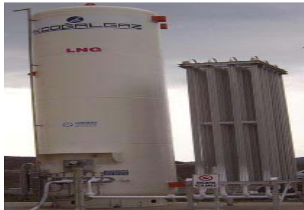
Şekil 2.12'de Sıvılaştırılmış Doğal gaz Depolama tankı[22]
