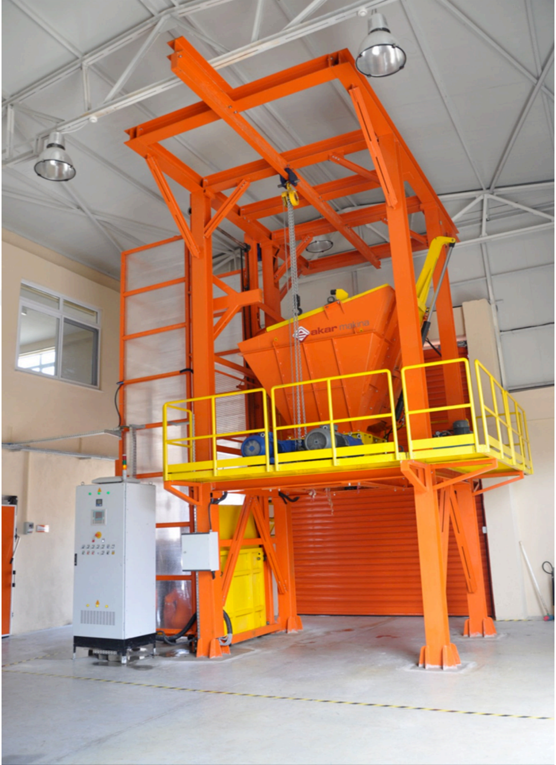
Şekil 3.7. Mersin ili tıbbi atık sterilizasyon tesisi kırıcı ünitesi
