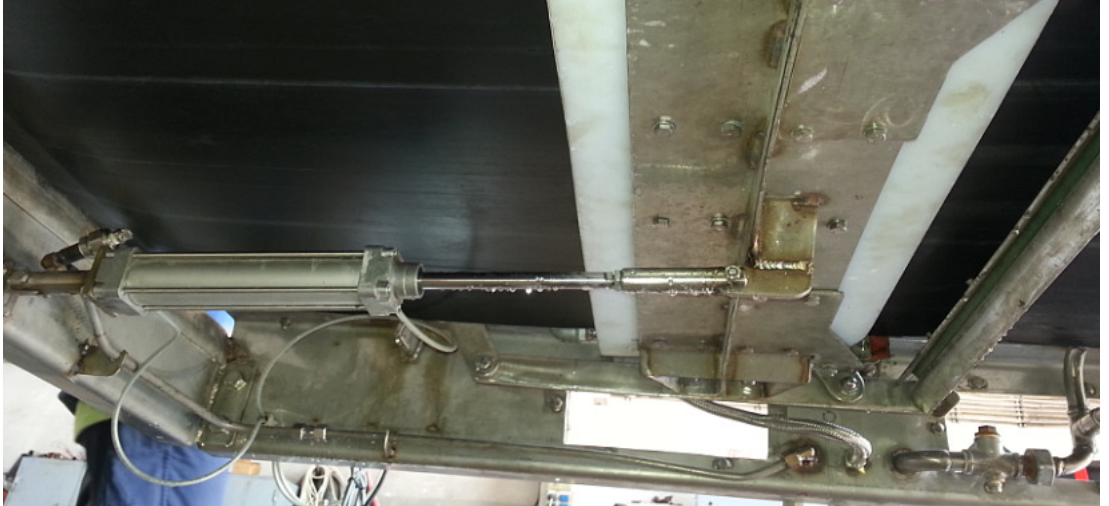
Şekil 4.55. Üst şerit yıkama tesisatı montajlı fotoğrafı
