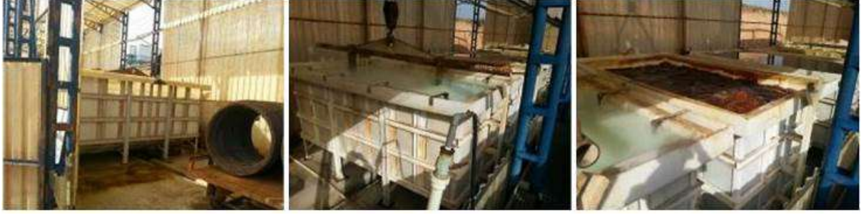
Şekil 3.2. Çinko Fosfat Kaplama Tesisi
