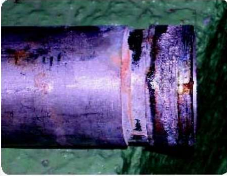
Şekil 2.6. Aralık Korozyonu Örnek Görüntüsü
