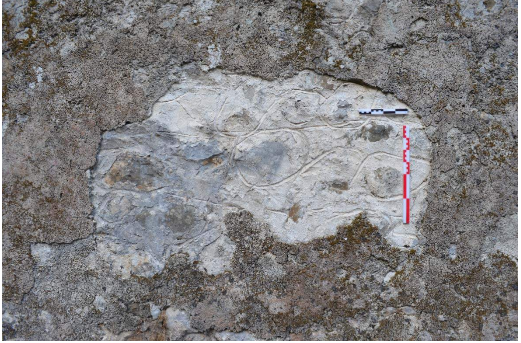
a) Piskoposluk Kilisesi dalgali çizgili derz harcı.
