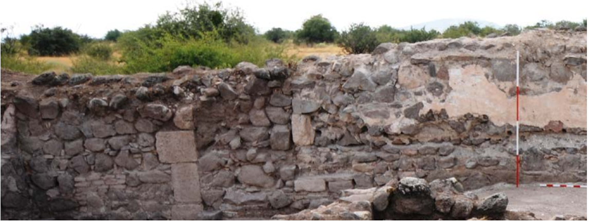
Resim 19. Y Alanı 3 No'lu Mekan Duvarındaki Kapı Sövesi Detay 2012
