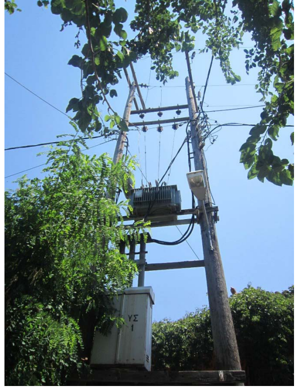
Görsel 296. Elektrik direkleri, Yunanistan
