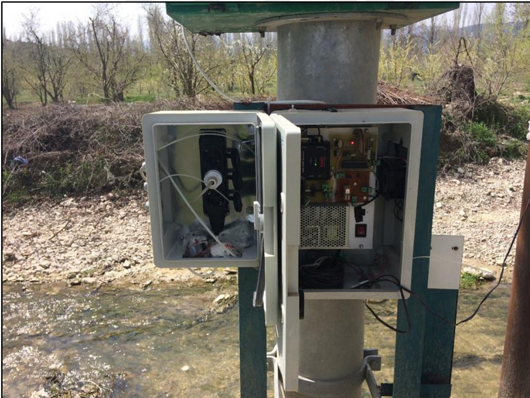
Fotoğraf 3.5 Elektrik Bağlantısının Sağlandığı ve Seviye Sensöründen Verilerinin Alındığı Panolar
