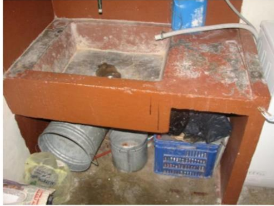
Görsel 4.18: Mutfakta bulunan beton lavabo (Çağanağa,2011).
