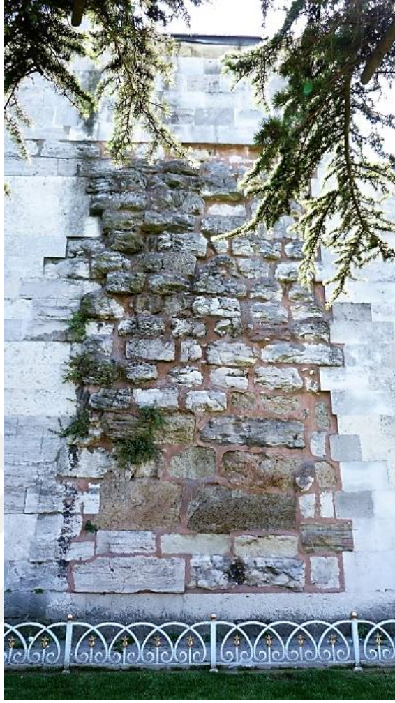
Resim 100. Sıbyan mektebi doğu cephesinde yıkılmış ihata duvarı izi.
