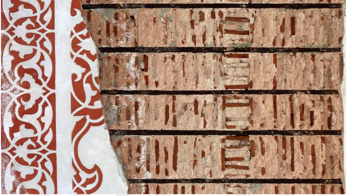
Resim 119. Sultan Ahmed Camii doğu cephesi üst mahfelin döşeme altında sıvası dökülen kısımdan demir hatıllar
