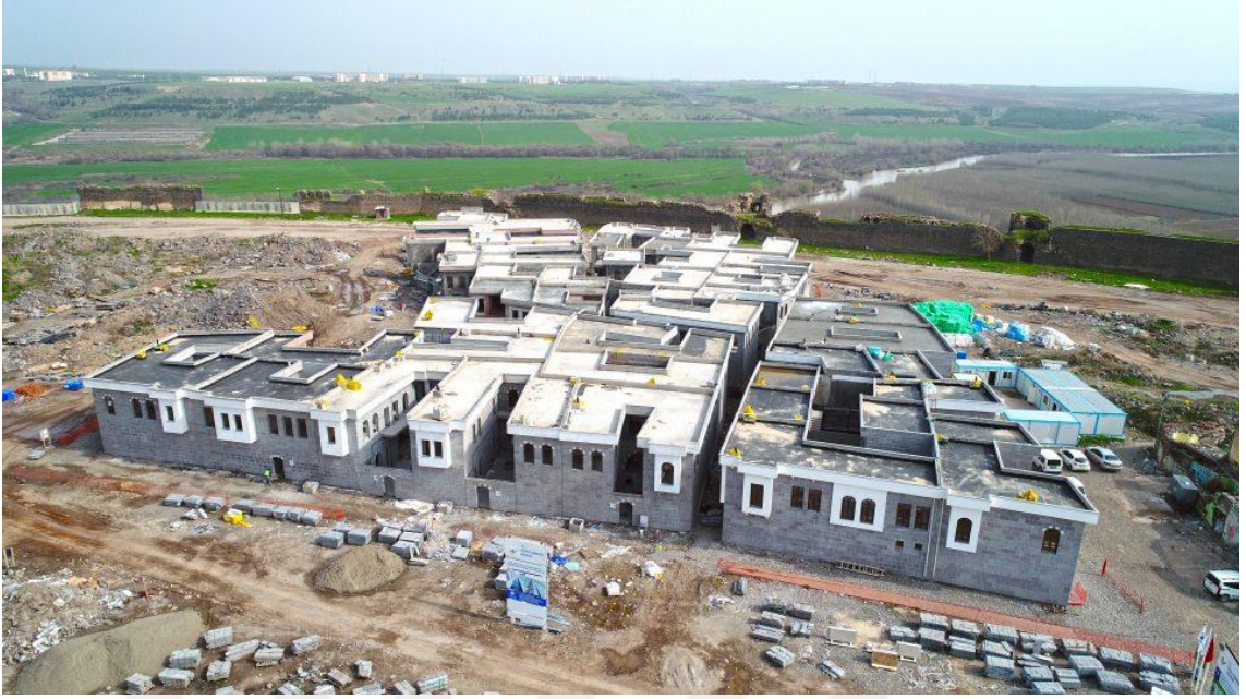
Foto 28: Suriçi Kentsel Dönüşüm ve Yenileme Projesi kapsamında inşa edilen geleneksel Diyarbakır Konakları.
