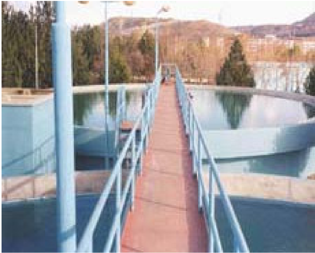
Resim-6 Çamur Koyulaştırma Ünitesi
