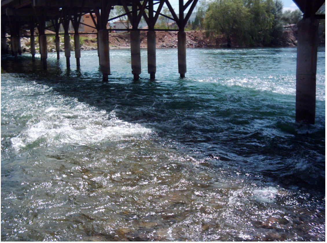
EK-5. Dördüncü istasyon (Bahşili İlçesi Mevkii) ' a ait resim
