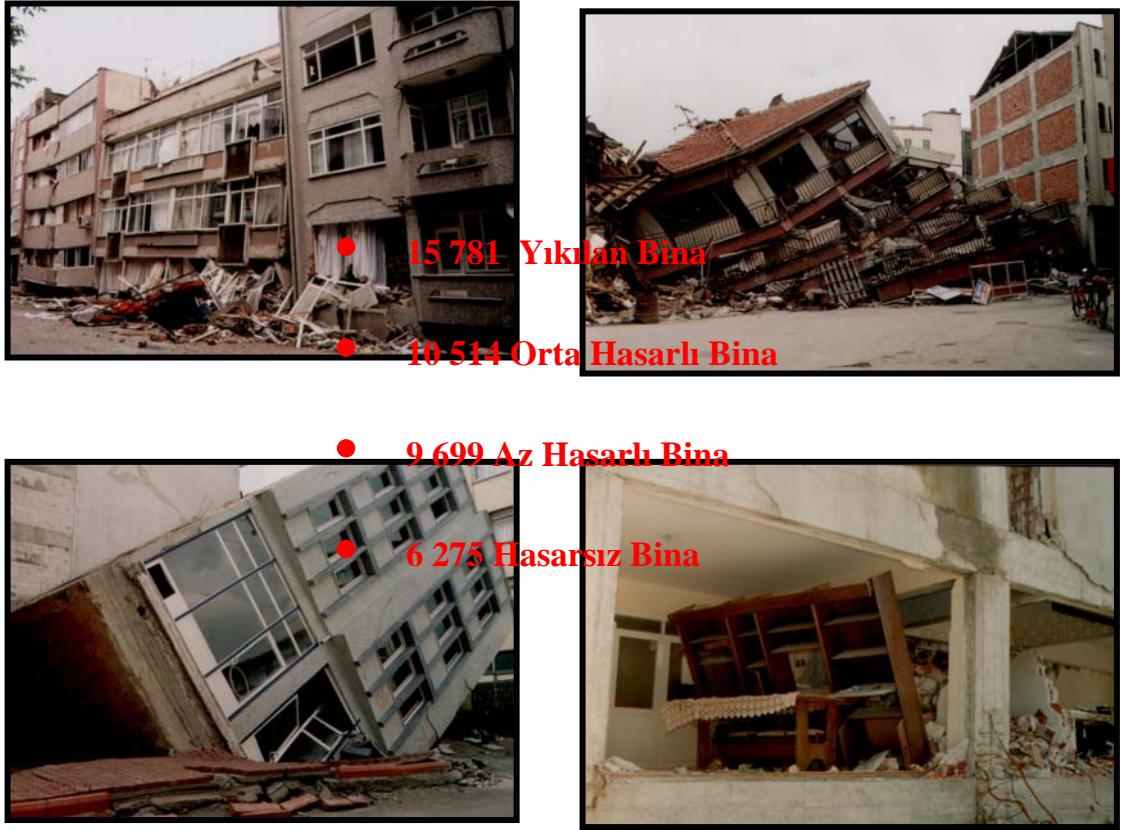
Resim 5.1. 1999 Doğu Marmara Depremi sonrası Adapazarı kentinde yıkılan ve hasarlı duruma geçen binalar
