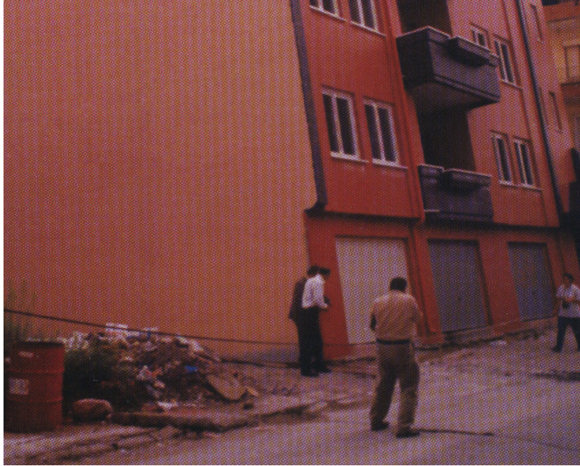
Resim 4.1. 1999 Marmara depreminde görülen sınılaşma hasarı [85]
