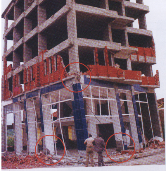
Resim 4.4. 1999 Marmara depreminde görülen yumuşak kat hasarı [85]
