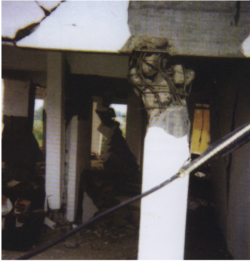
Resim 4.2. 1999 Marmara depreminde görülen taşıyıcı sistem düzensizliği hasarı[85]
