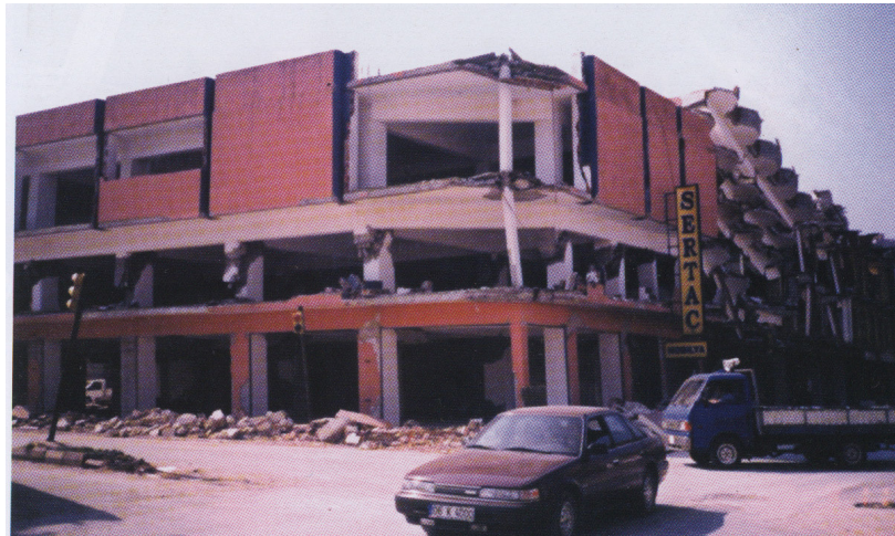
Resim 4.5. 1999 Marmara depreminde görülen kısa kolon hasarı [85]
