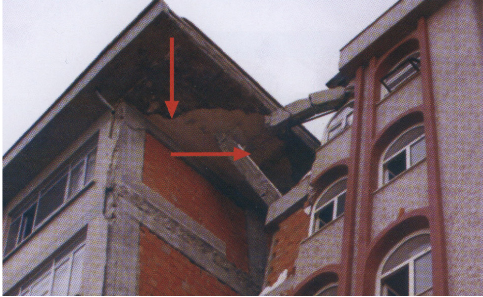
Resim 4.3. Marmara depreminde görülen çekiçlemeden kaynaklı hasar [85]
