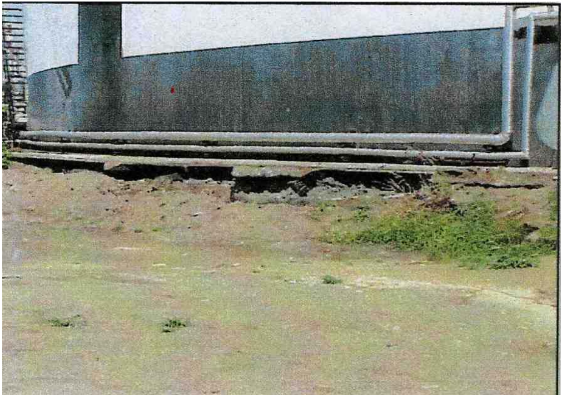
Resim 5.12. Bazı tankların temellerinde çökmeler meydana gelmiştir [12]
