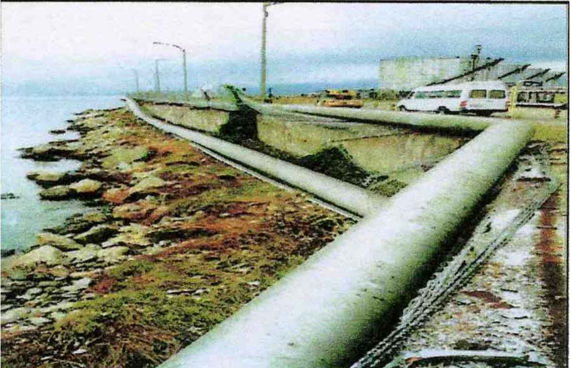
Resim 5.2. Deprem esnasında borularda çökme meydana gelmiştir [12]
