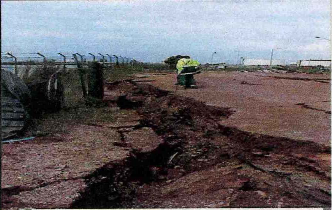
Resim 5.1. Dolgu alanında çatlaklar oluşmuştur [12]
