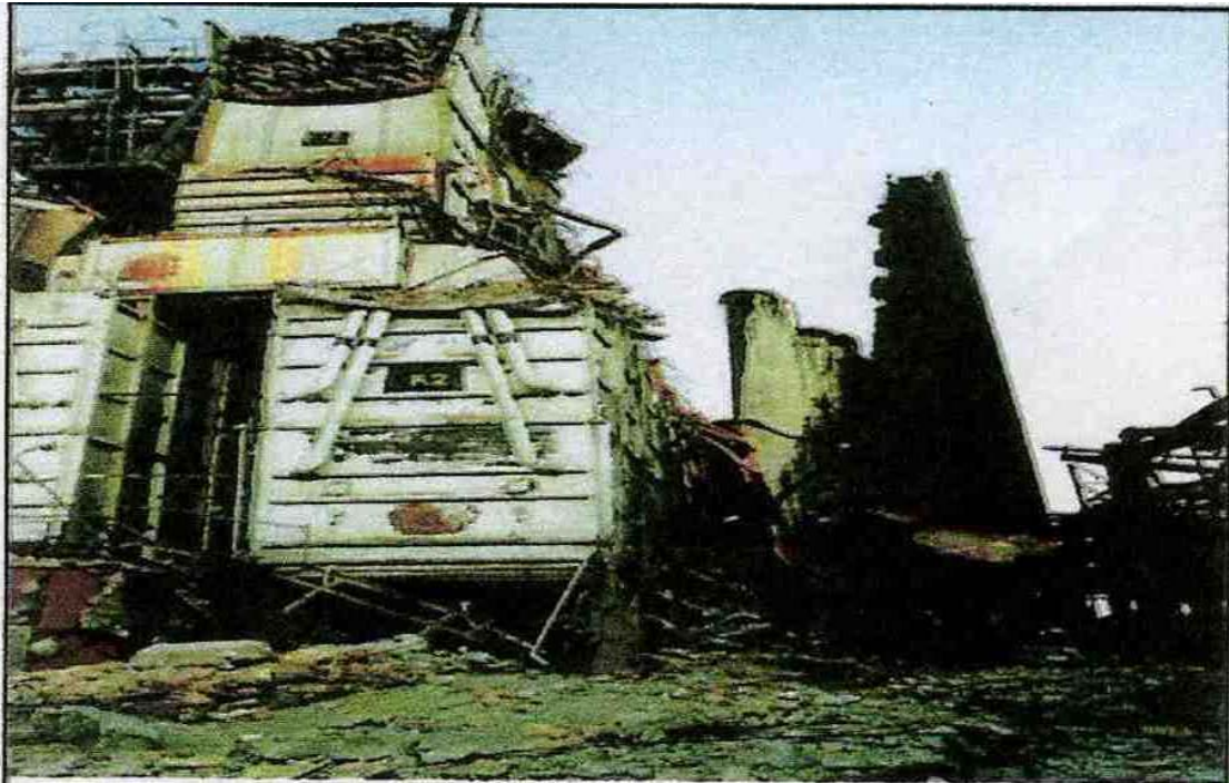
Resim 5.15. Şarj firını ağır hasar görmüştür [12]
