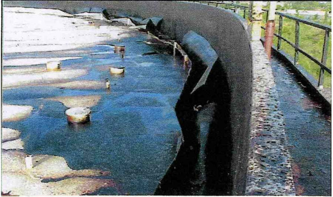
Resim 5.13. Tank contaları ağır şekilde hasarlanmıştır [12]
