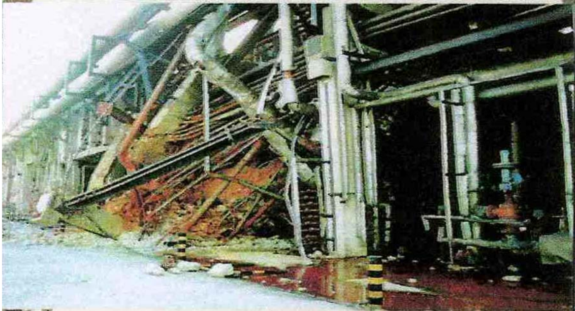
Resim 5.17. Ürün ve yardımcı servis hatları kopmuş, yangın 4 saatte söndürülmüştür [13]
