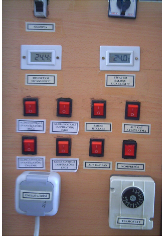
Resim 6.12. Kontrol panosunun görüntüsü
