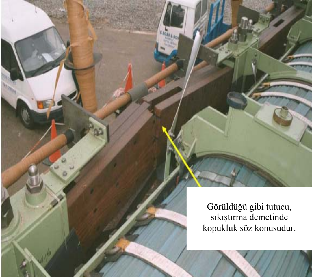
Resim 6.1. Trafonun üst baskı elemanlarında kırılma meydana gelmesi [42]
