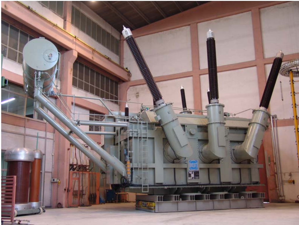
Resim 2.2. Ülkemizde imal edilen 380/154 kV 250 MVA güç transformatörü [6]
