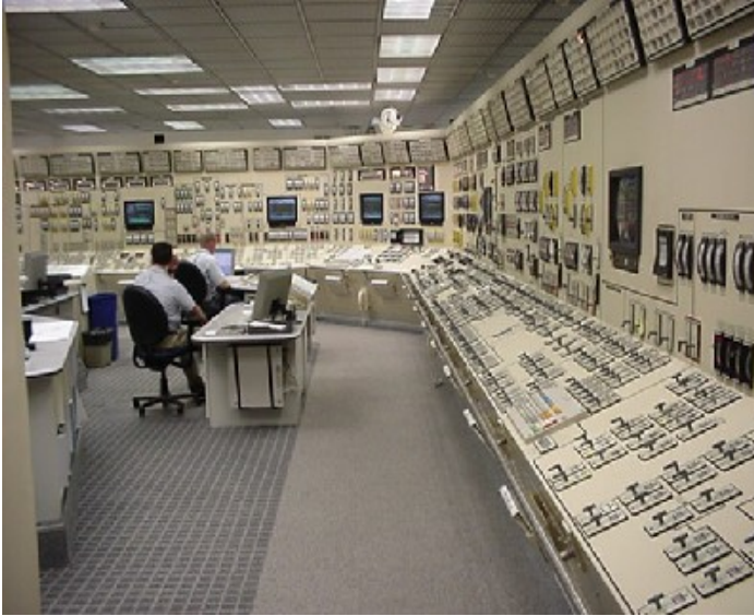
Resim 3.8. Nükleer enerji santrali kontrol odası [18].
