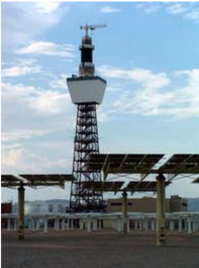
Resim 3.5. Güneş enerjisi üretim panelleri [16].
