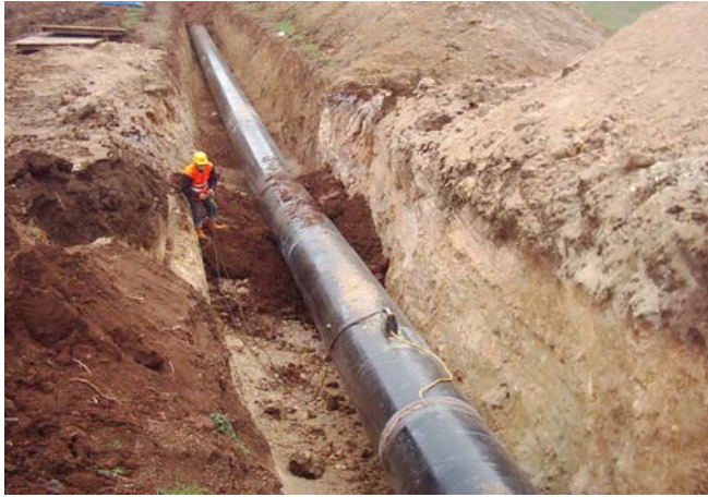
Resim 5.1. Doğalgaz boru hattının görünüşü [47]
