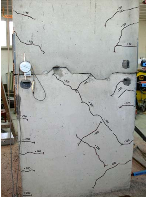
Resim 4.14. 200kN yük altında oluşan çatlaklar
