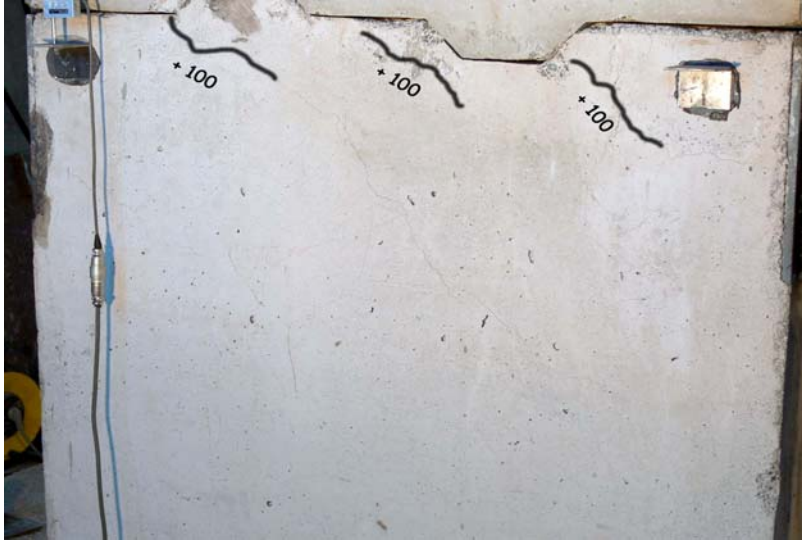
Resim 4.11. 100kN yük altında oluşan çatlaklar
