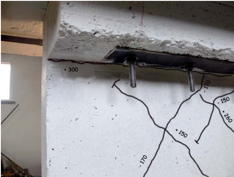
Resim 4.6. 300kN'da oluşan çatlaklar
