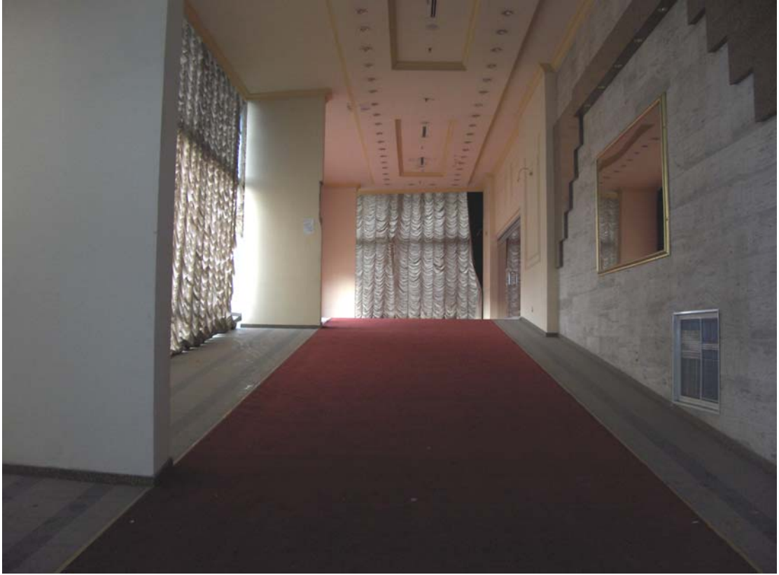
Resim 4.3. 1966-2005 arası yapılan tadilatların izleri, [Turgut, 2005]
