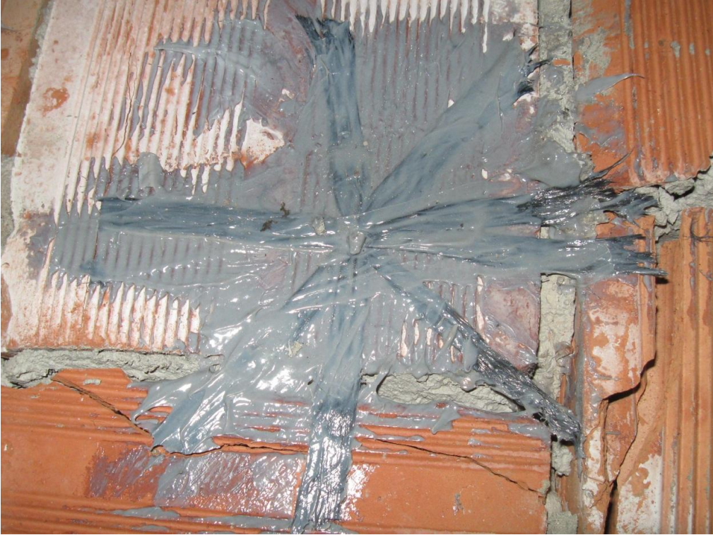
Resim 4.7. Ankraj çevresi tuğla çatlakları
