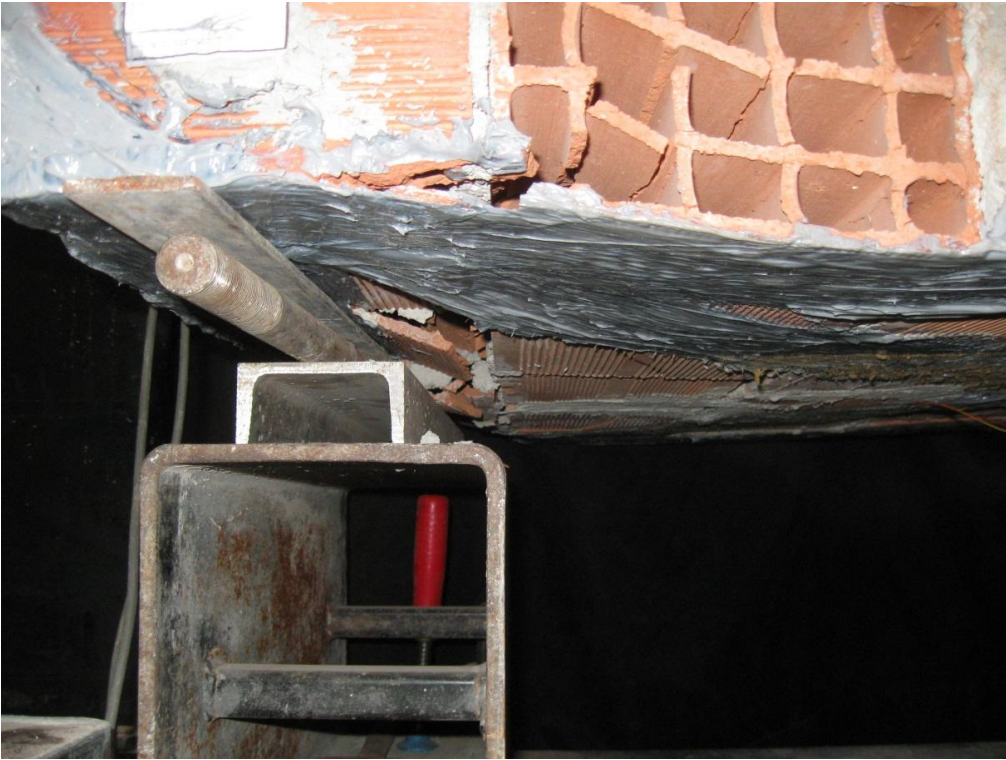
Resim 4.13. CFRP şeritlerin yüzeyden ayrılması ve tuğlaların parçalanması
