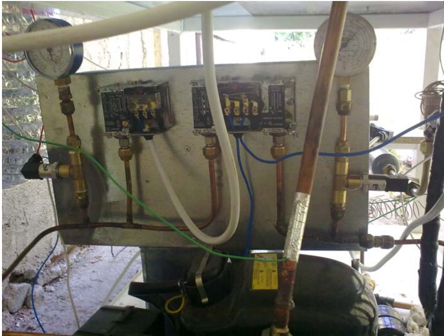
Resim 5.3. Manometrelerin ve basınç transmitterlerin bağlantısı
