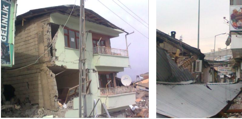
Resim 1.2. Van depreminden ağır hasarlı binalar
