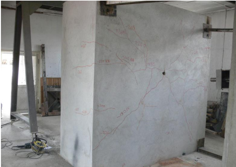
Resim 5.7. Deney düzeneği söküldükten sonra D 2 duvar örneğinde ön ve sol yan yüzeyde oluşan çatlak deseni
