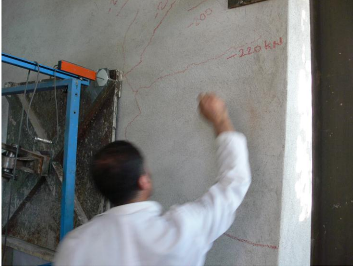
Resim 5.6. -220 kN' luk uygulanan çekme kuvveti ile dış yüzeyde oluşan çatlaklar
