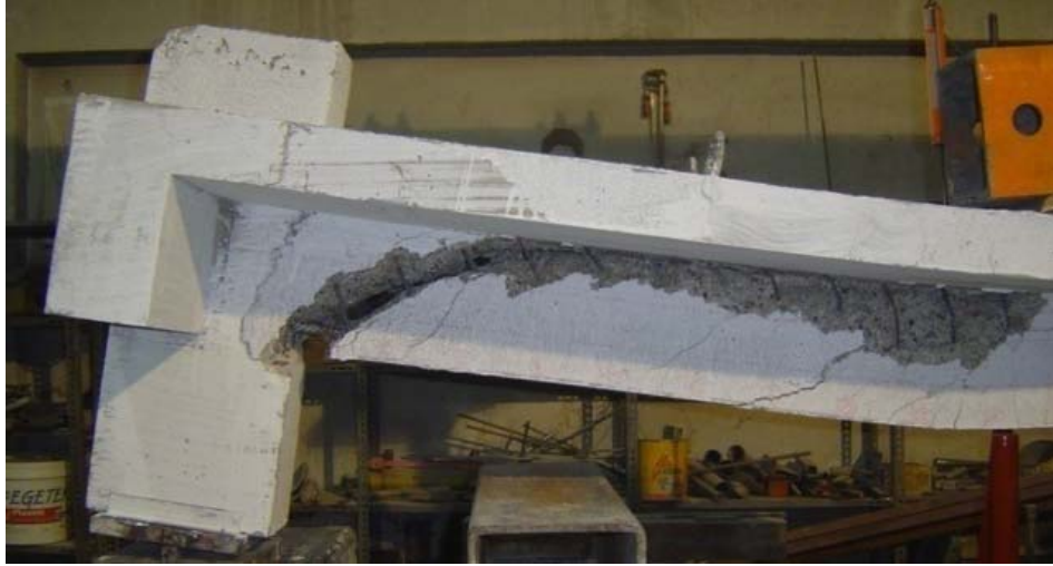
Resim 3.55. HAU elemanında meydana gelen kesme çatlakları
