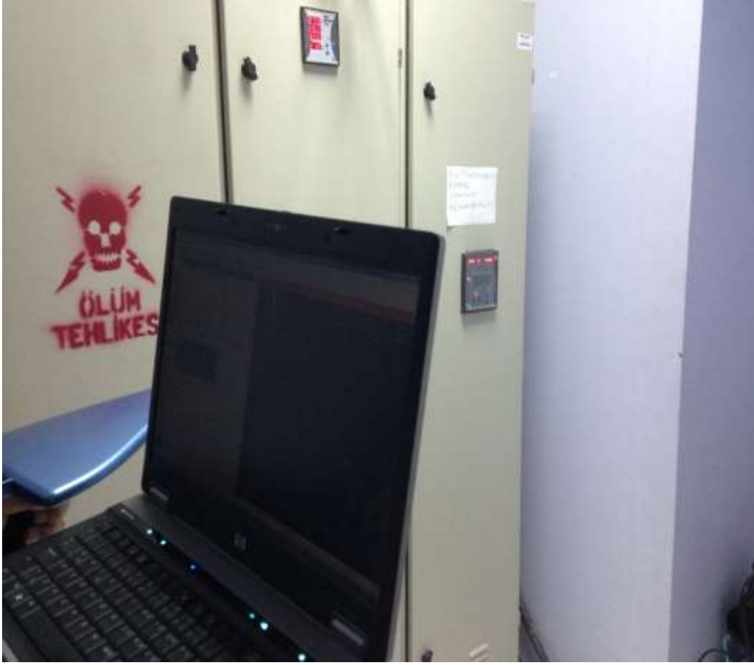
Resim 7.7. Elektrik Tesisat Odası
