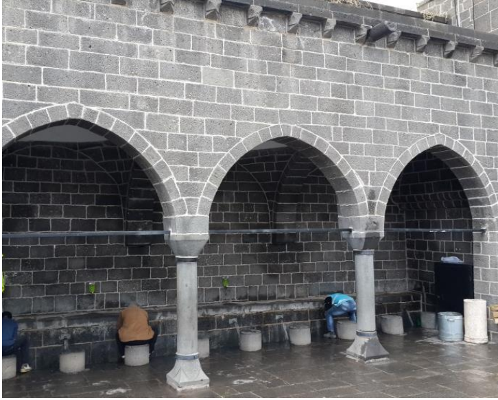
Resim 4.4. Diyarbakır İç Kale Camisi'nin avlusunda bulunan kemer ve sütunlar (Yasemin Baran arşivi,2014)
