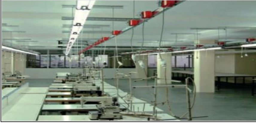
Resim 6.32. Konfeksiyon bölümünde güvenli elektrik tesisatı [21]
