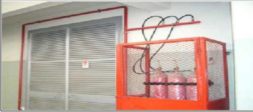
Resim 6.34. Trafo odasında CO 2 söndürme sistemi
