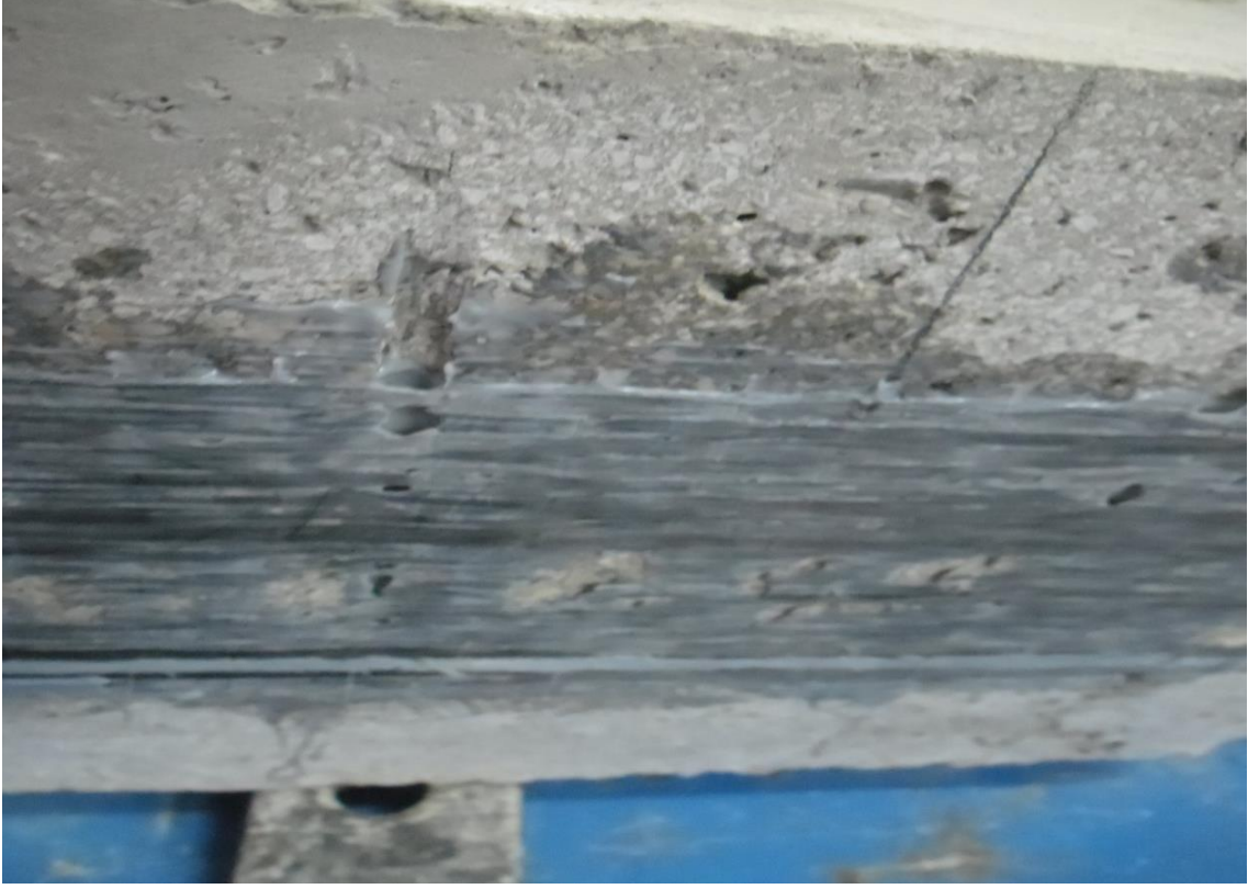
Resim 5.43. Deney elemanı 100W200L1F göçmeden sonraki görünüşü
