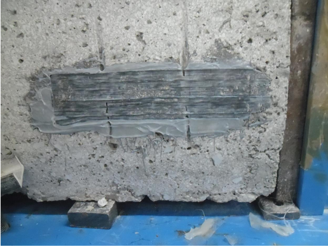
Resim 5.29. Deney elemanı 50W200L2F göçmeden sonraki görünüşü
