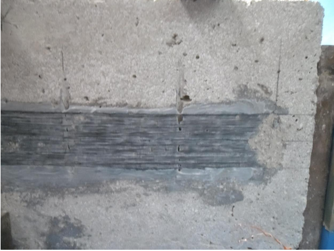
Resim 5.37. Deney elemanı 50W280L2F göçmeden sonraki görünüşü
