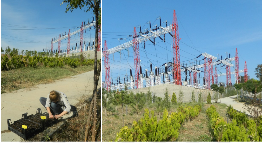
Resim 1.2. Bitkilerin yetiştirildiği trafo merkezi
