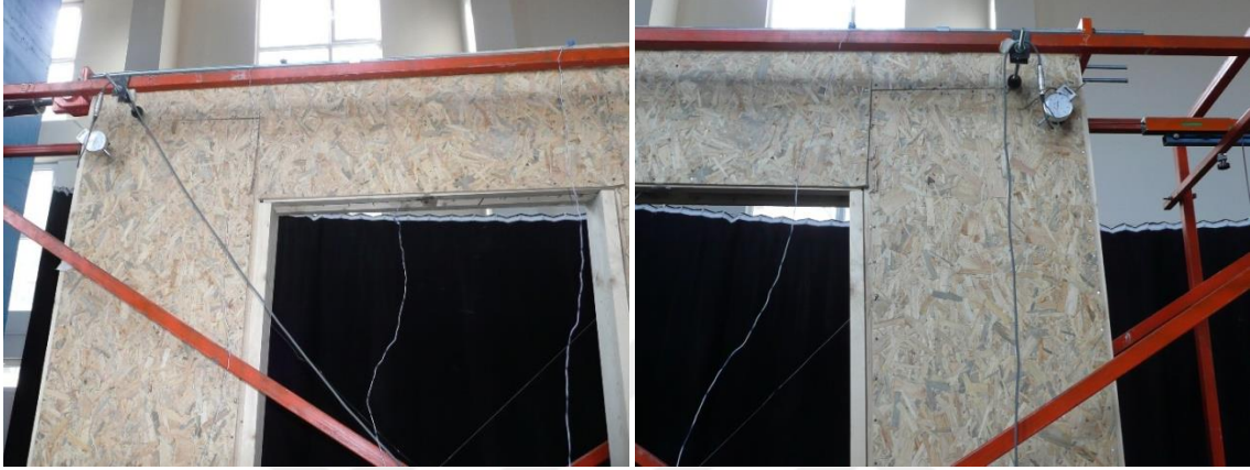
Şekil 4.20. Model-2’de meydana gelen hasarlar
