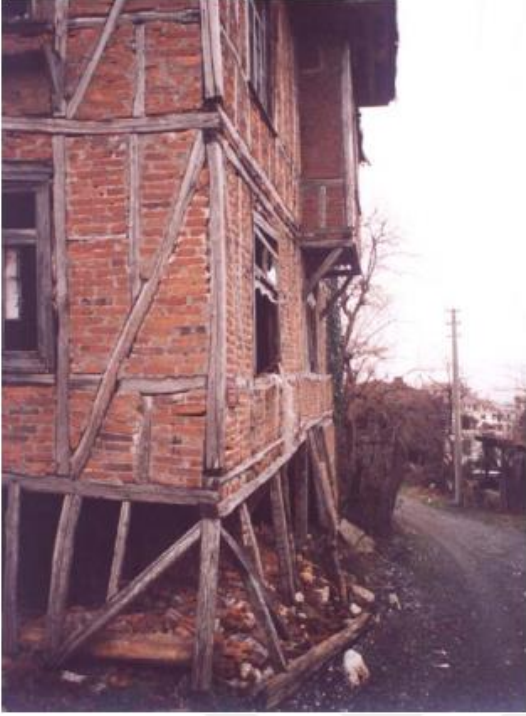
Şekil 2.6. 1999 depreminde zarar gören ahşap yapı (Aksoy ve Ahunbay, 2005)
