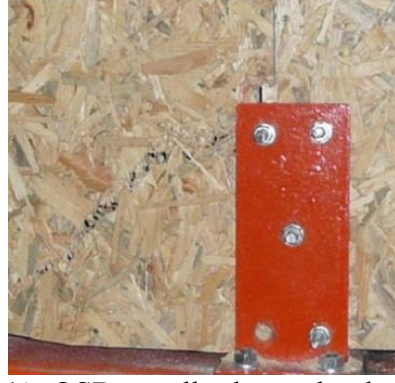
b) OSB panellerde yırtılmalar
