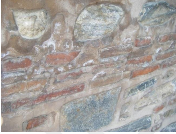
Resim 2.2. Onarımında çimento kullanılmış bir yapı duvarında beyaz renkli tuz kristalleri oluşumu
