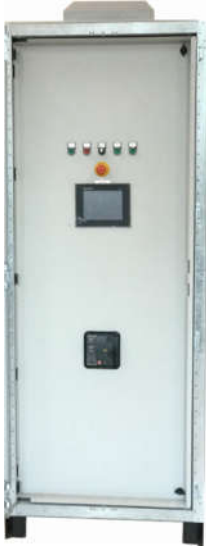
Resim 4.2. Pano ön görünümünde bulunan ekipmanlar
