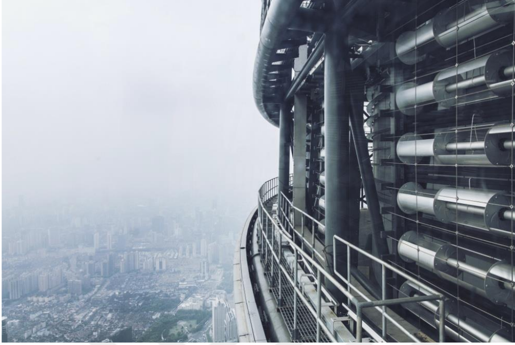
Resim 5.19. Kulenin bitiş parapetine yerleştirilen rüzgâr türbinleri (URL-53)
