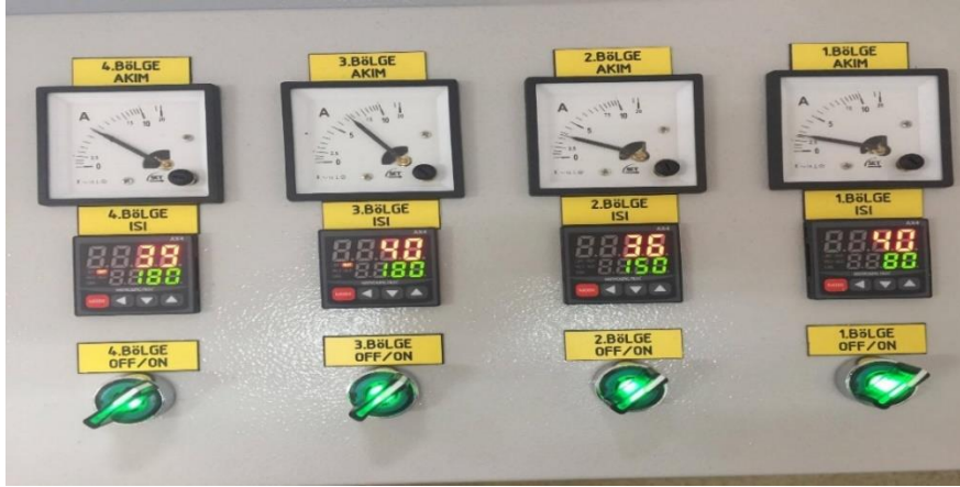
Şekil 7.8. Sıcaklık kontrol paneli
