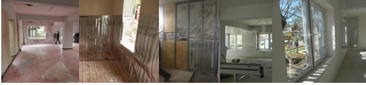
Resim 4.13. Yerden ısıtma sistemi-iç mekan uygulaması (Salaman Gürcan,2018; URL-95)
