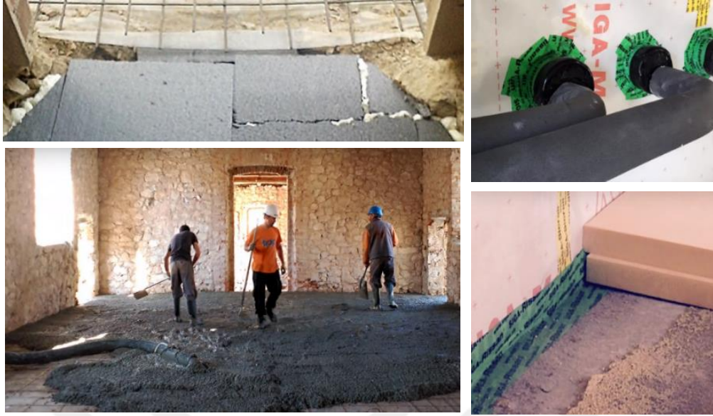
Resim 3.53. Döşeme yalıtım-hava sızdırmazlık detayları ve uygulaması-boru hava sızdırmazlık detayı-yapı havalandırması-ısı köprüleri oluşmaması adına sürekli hava bariyeri uygulamasının (URL-85)
