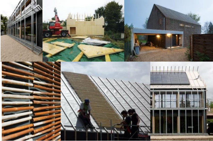
Resim 3.18. Ahşap ana bina-bambu-çelik strüktürlü binayı komple saran ikinci cephe- renk değiştiren bambu kaplama-çatı üzeri bambu kaplama montajı (URL-53; URL-54)
