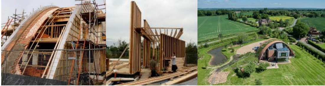
Resim 3.11. Ahşap strüktürlü ana bina ve kompleks tuğla kubbenin detayı- kubbe ve yeşil çatıdan bir görünüm (URL-38; URL-42)
