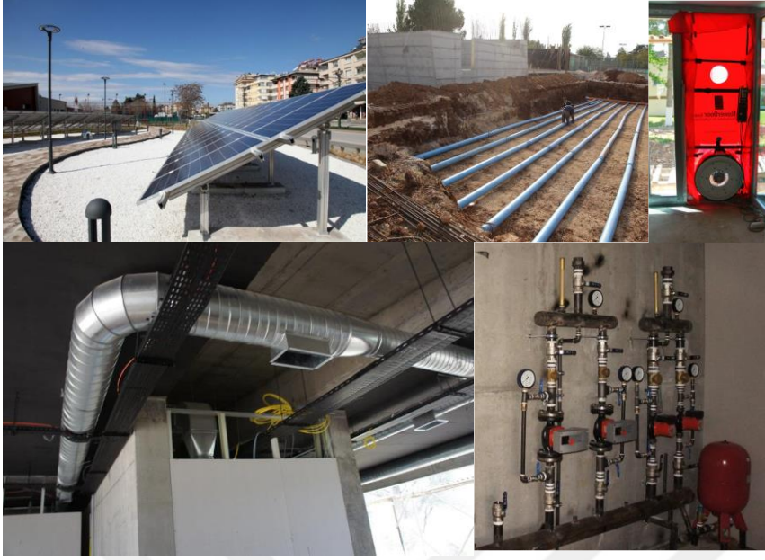
Resim 4.8. Bina dışında kurgulanmış fotovoltaik paneller- kanada kuyusu sistemi- havalandırma boruları ve sistemi (URL-90)
