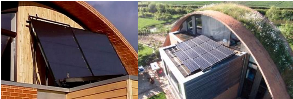
Resim 3.14. Sıcak su için güneş paneli ve fotovoltaik panellerin görünümü (URL-46)
