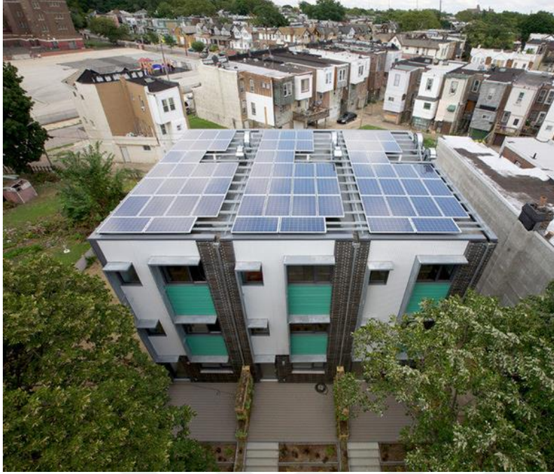
Resim 3.29. Fotovoltaik paneller (URL-60)
