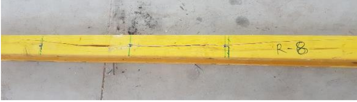
Resim 4.36. Deney elemanı-8 üzerinde 1120 mm çatlak oluşumu
