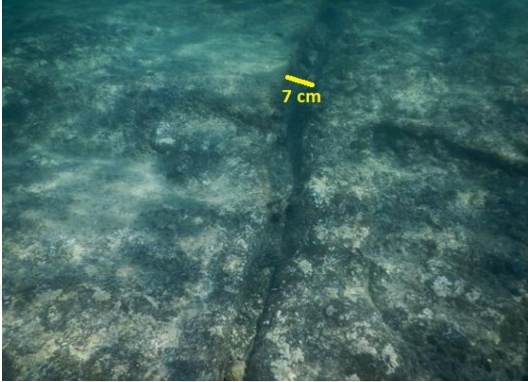
Şekil 4.33. Phaselis'te sualtında görülen çatlaklar.
