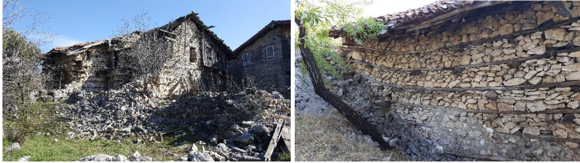
Resim 4.12. Terk edilen yapılarda görülen yapısal sorunlar
