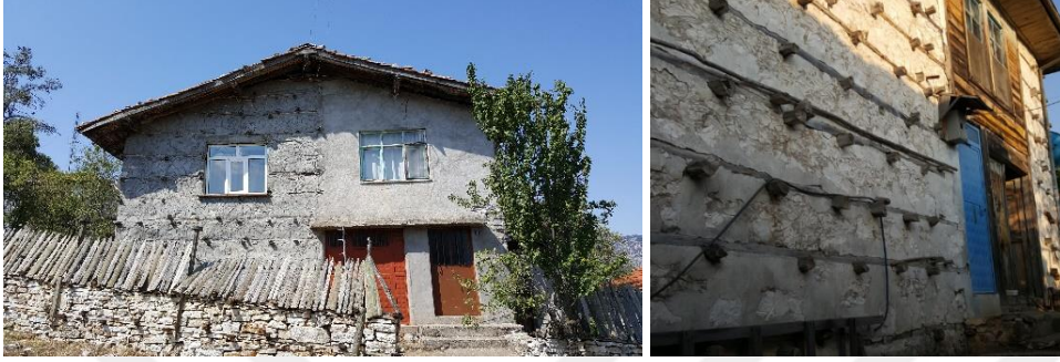
Resim 4.22. Yapıya sonradan eklenen metal kapıların cephe karakterini olumsuz etkilediği örnekler
