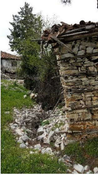
Resim 4.11. Yıkılma tehlikesiyle karşı karşıya kalan bir duvar
