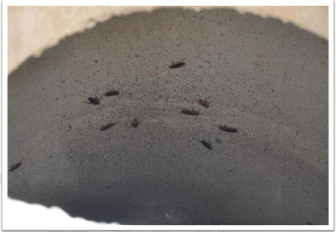
Şekil 3.3. Kablo kanalı rögarındaki P. americana bireyleri
