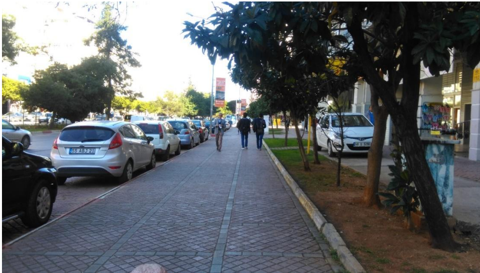
Şekil 4.42. Yüzüncü Yıl Bulvarı yürüme yolu döşemelerinin fiziksel durumu
