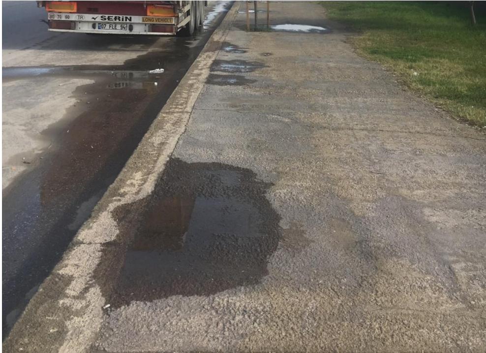
Şekil 4.11. 75. Yıl Caddesi kaldırımlarda su birikintisi durumu
