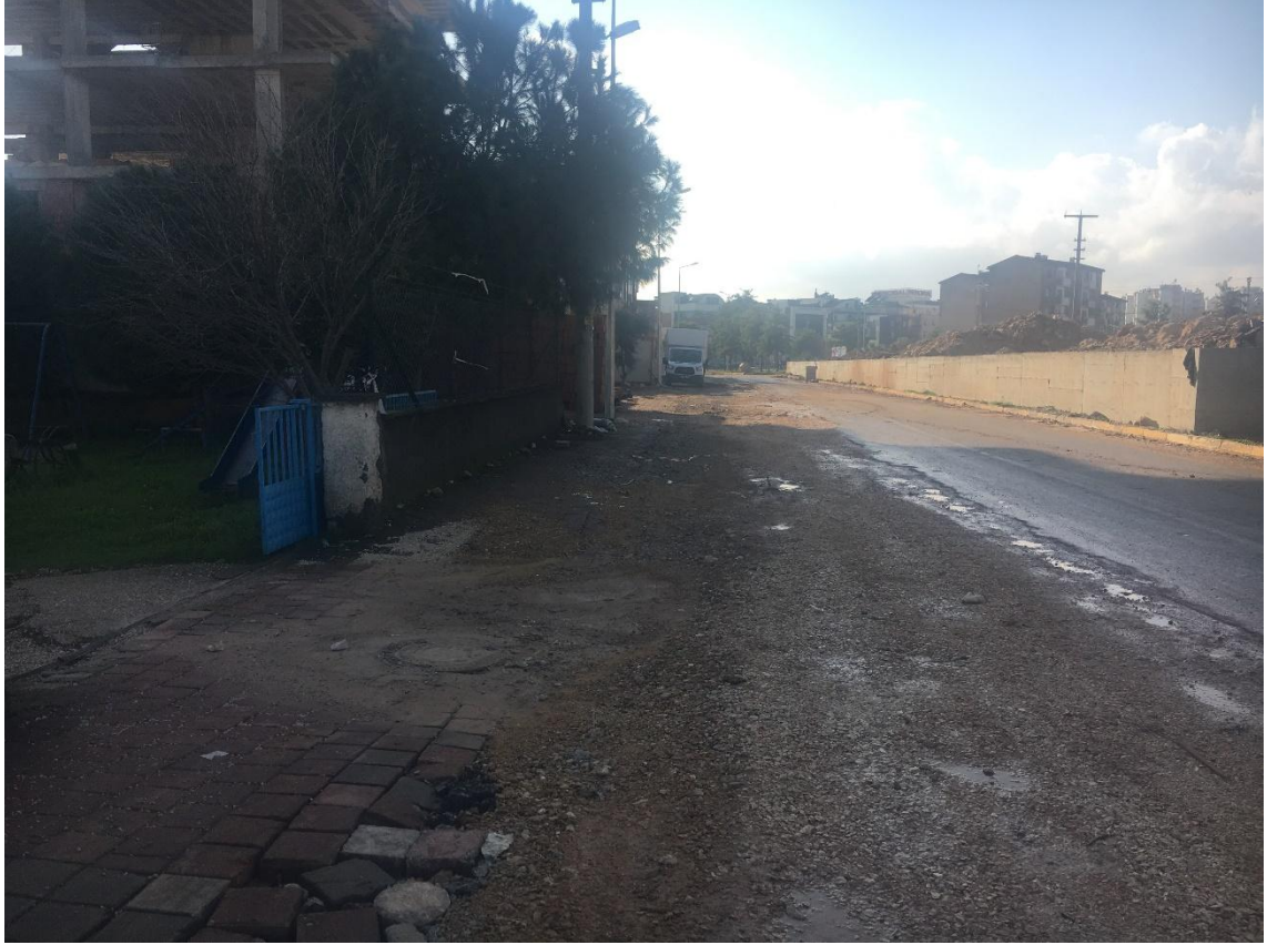
Şekil 4.5. Ceyhan Caddesi yürüyüş yolları döşemelerinin fiziksel durumu
