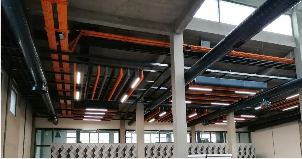
Resim 3.63. Yemekhane alanının açık tesisat sistemi
