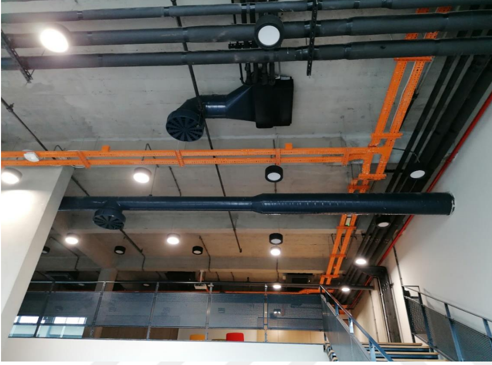
Resim 3.62. Eğitim binasının açık tesisat sistemi
